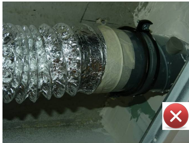
Abbildung 26: Abklebung Mangelhafte Abklebung mit ungeeignetem Klebeband
