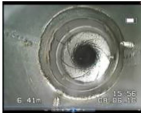
Abbildung 45: Abluftleitung, Blick auf Irisblende
