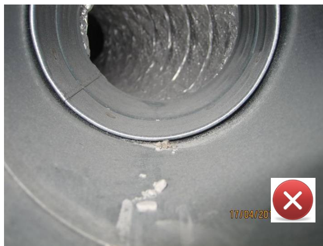
Abbildung 27: Zuluftleitung vor Zuluftdurchlass. Feiner Staubbelag sichtbar.
