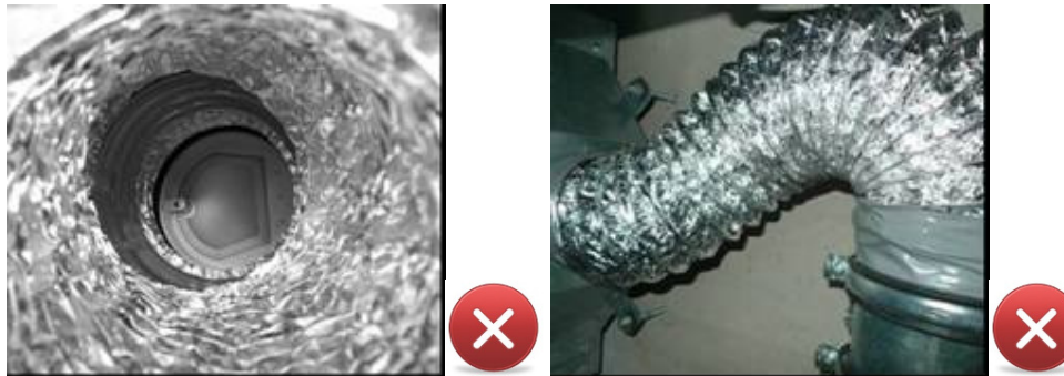
Abbildung 80: nicht zulässige Folienschläuche, Innen- und Außenansicht
