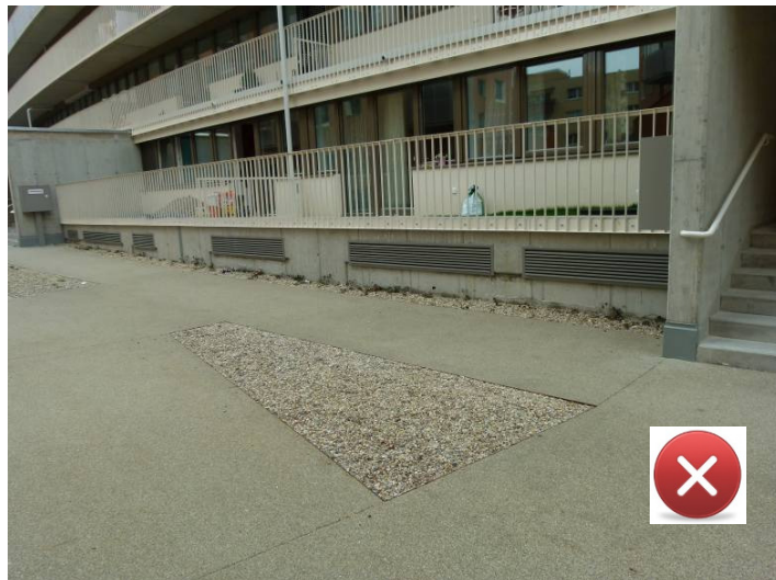
Abbildung 10: Außenluftansaugung in zu geringer Höhe.
