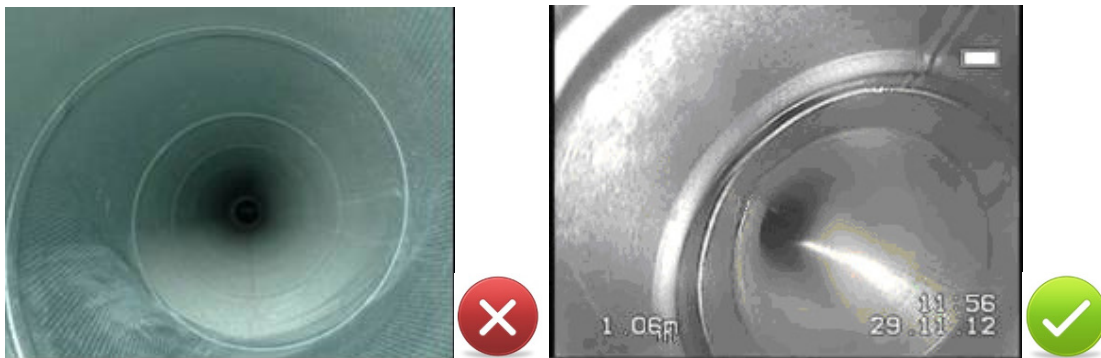
Abbildung 85: Zuluftleitungen mit Grenzwertiger und akzeptabler Sauberkeit
