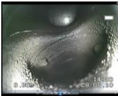
Abbildung 39: Abluftleitung, vor Abzweiger
