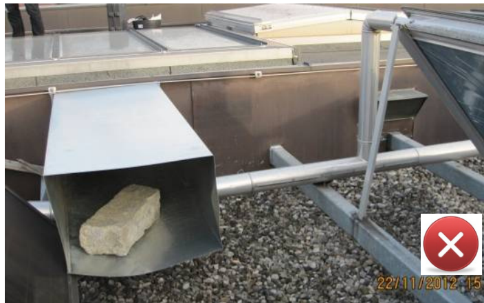
Abbildung 14: Nachträgliche unprofessionelle Verlängerung der Außenluftansaugung zur Vermeidung von Geruchsübertragung.
