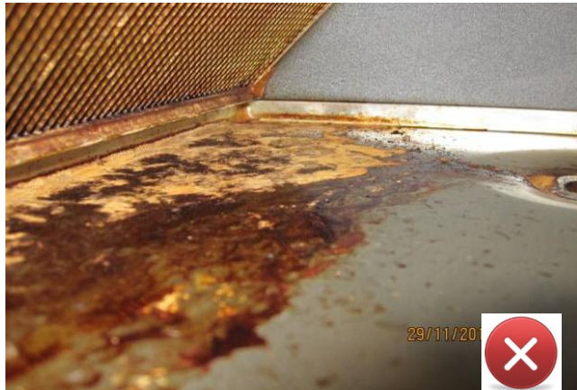
Abbildung 25: Blick ins Lüftungsgerät einer Raucherwohnung Verunreinigungen durch Küchenfett und Rauchinhaltsstoffe am Plattentauscher und in der Tropftrasse.
