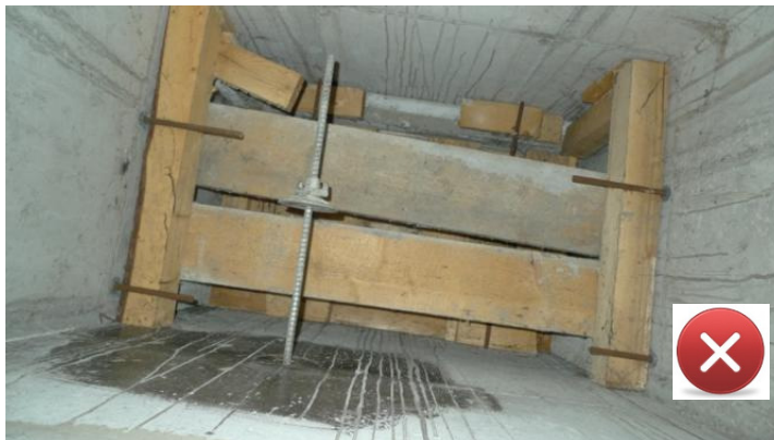
Abbildung 16: Außenluftschacht (vergessene Schalung)
