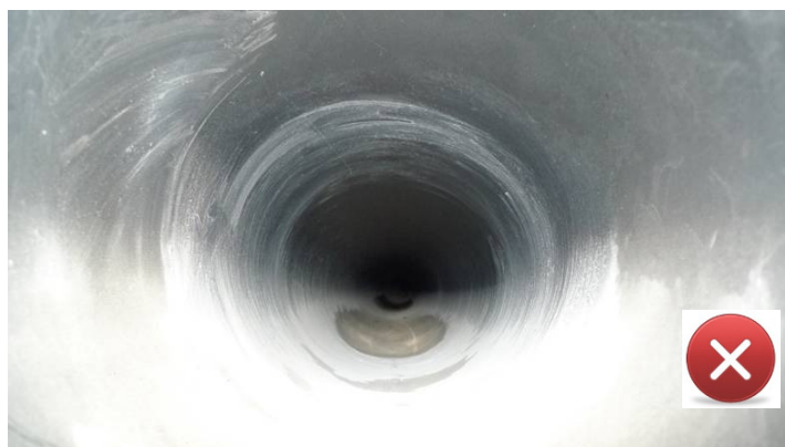
Abbildung 17: Außenluftansaugung EWT: EWT Rohr aus PE (DN 300)
