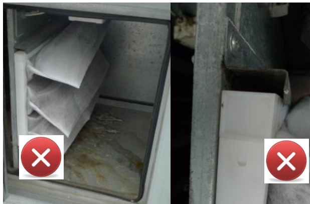
Abbildung 20: Taschenfilter 1. Filterstufe, Filtereinbausituation Aufgrund der Einbausituation verringert sich die Filterfläche.
