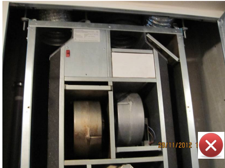
Abbildung 23: Ablagerungen von Rauchinhaltsstoffen im Lüftungsgerät
