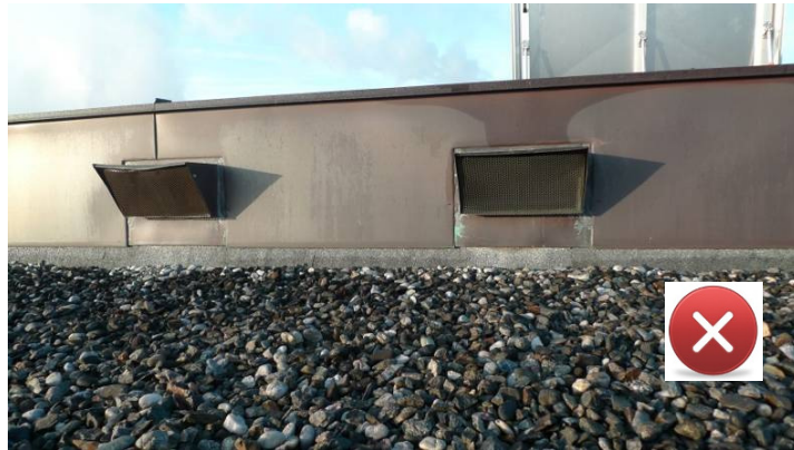
Abbildung 9: Außenluftansaugung neben Fortluftöffnung
