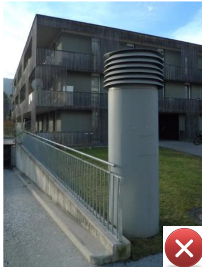
Abbildung 12: Außenluftansaugung neben einer Tiefgaragenabfahrt
