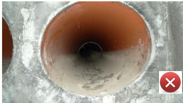
Abbildung 15: stark mit Grobschmutz verunreinigtes, erdverlegtes Außenluftrohr
