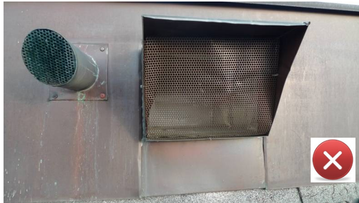
Abbildung 13: Außenluftansaugung neben Fallstrangentlüftung
