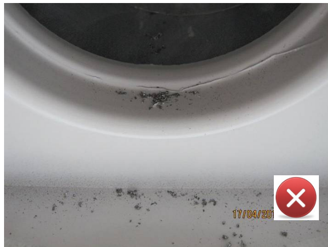
Abbildung 29: Zuluftleitung vor Zuluftdurchlass. Metallrückstände sichtbar.
